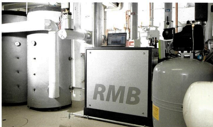
Zur neuen Heizungsanlage gehört ein Blockheizkraftwerk von RMB.
