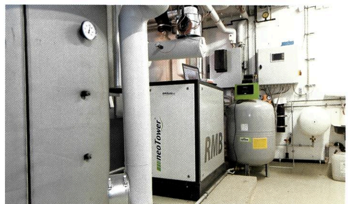
Die Betriebsdaten der gesamten Anlage werden online in die Leitzentrale von Lava Energy übertragen.
