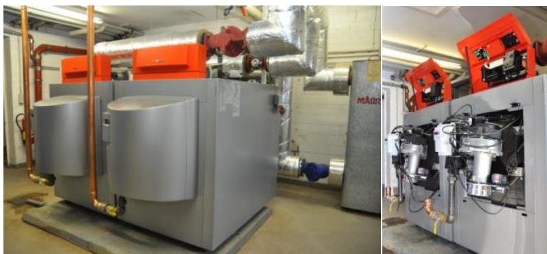
Doppelkesselanlage im Objekt Schillerstraße 26: In den vergangenen Wochen wurden im Rote-Mühle-Quartier in Wittstock insgesamt vier Heizungsanlagen auf der Basis von Gaskesseln, Brennwerttechnik und Energiepumpen installiert. (Bilder: Christamaria Ruch)
