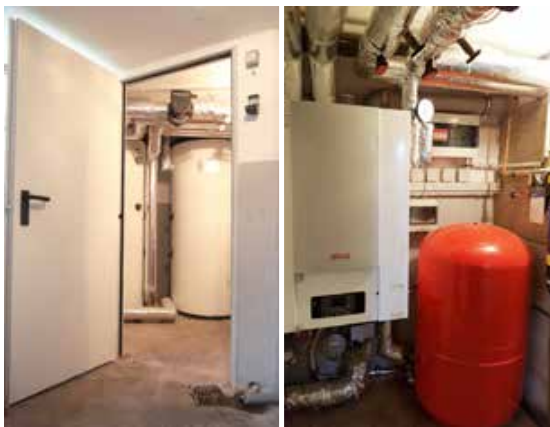
Pro Gebäude ein Heizraum mit zentralem Gas-Brennwertkessel, Pufferspeicher und Lava-Box fürs Energiemanagement
