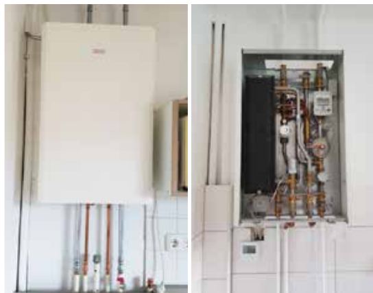
Dezentrale Trinkwassererwärmung: Übergabestationen mit Wärmehähler in jeder Wohnung
